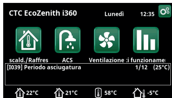
Esempio temperatura del periodo di asciugatura giorno 1 di 12 con setpoint attuale di 25 °C.
